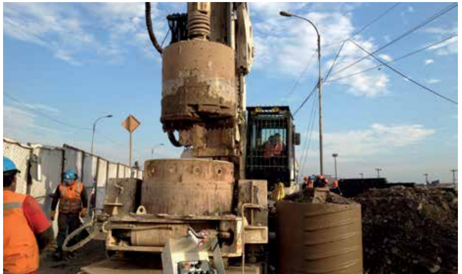
Figura 6 – Detalhe da ferramenta de coleta de detritos no interior do tubo camisa, após escavação, trituração e escarificação da ferramenta anterior. Observa-se ainda na parte inferior da camisa metálica de revestimento do furo, uma morsa, que abraça esta camisa metálica e a crava no solo, por movimentos de rotação e empurre, durante o processo de escavação
