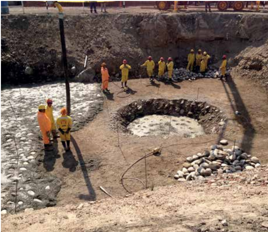
Figura 8 – Detalhe da execução de uma falsa sapata, para transpor uma camada de aterro orgânico e atingir a cota de implantação da sapata do viaduto
