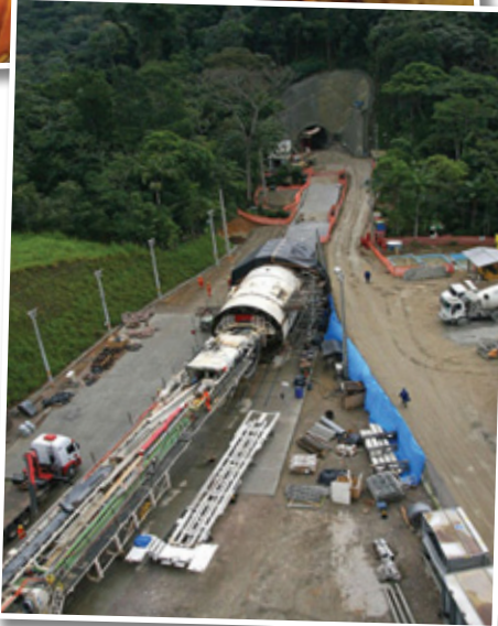
Foto 9 a 19 - Ilustram diversas etapas de construções de túneis em rocha com escavação mecanizada.
