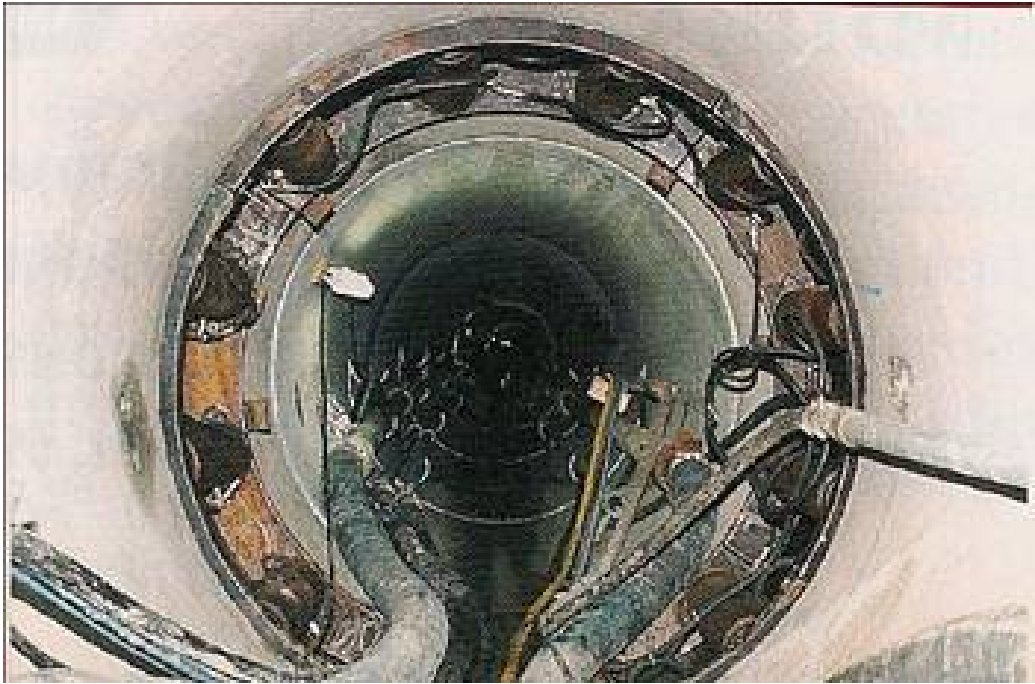
Foto 11 - Vista de Estação Intermediária de Cravação para Pipe Jacking de Grande Extensão
