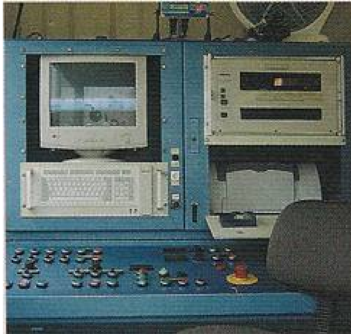
Foto 15 - Sistema Computadorizado Típico de Controle da Cravação
