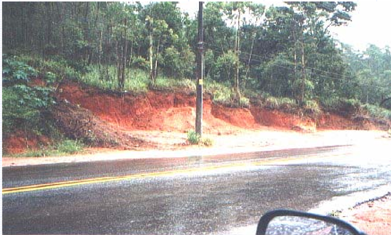
Foto 3 – Área de empréstimo, com erosão e talude vertical
