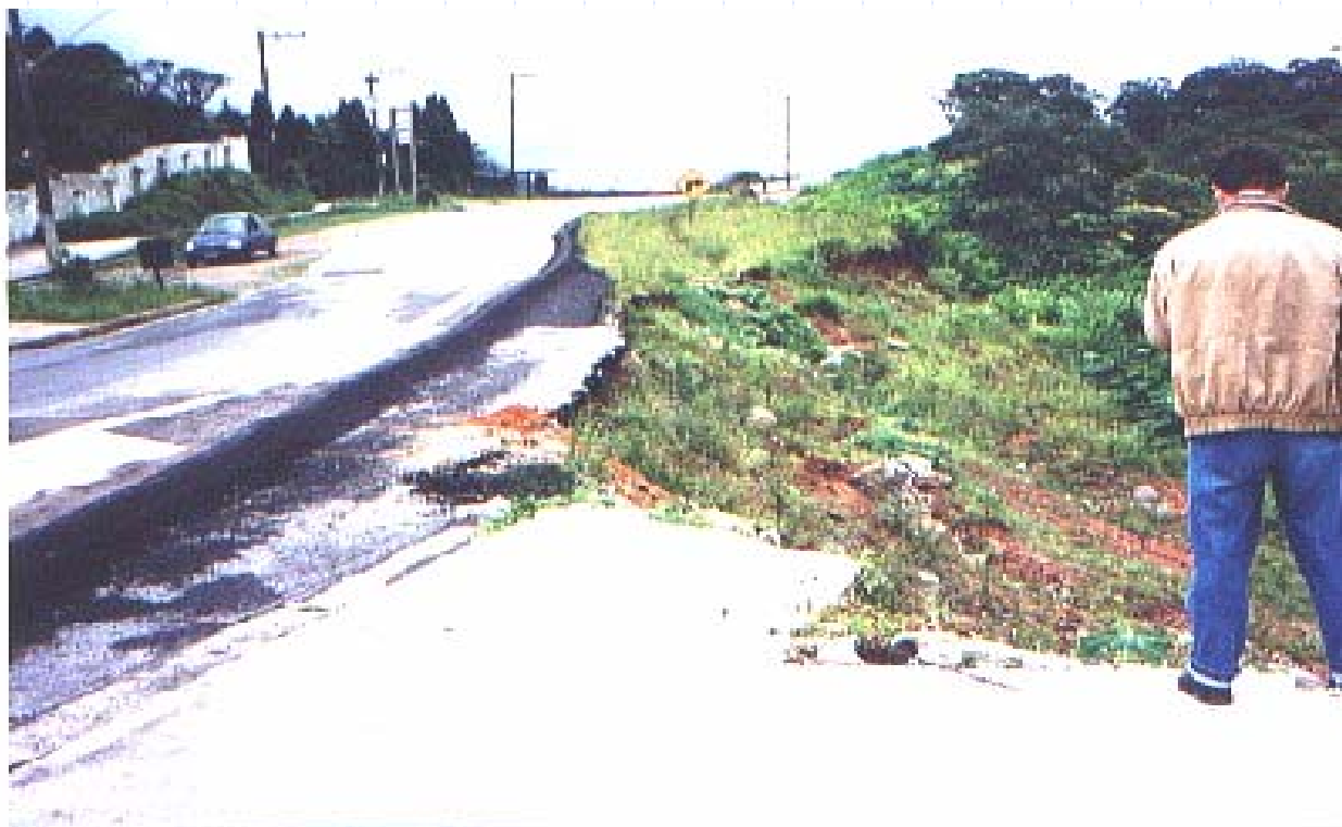
Foto 1 – Falha ou ruptura de talude de aterro
