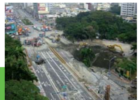
Figura 14 - Colapso de obra subterrânea no Metrô Kaohsiung, Taiwan, 2005
