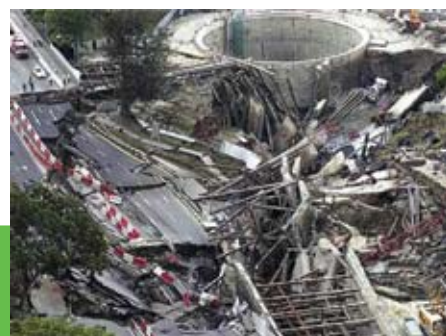
Figura 13 - Colapso em Cut and Cover de sistema viário em Cingapura, 2004
