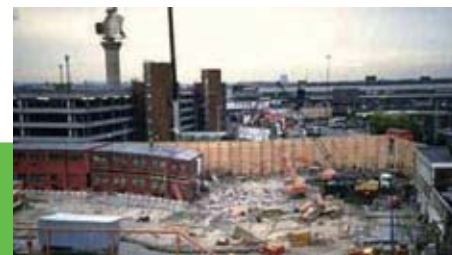
Figura 8 - Vista geral da área afetada pelo colapso (Heathrow, 1994), após demolição de edificações arruinadas
