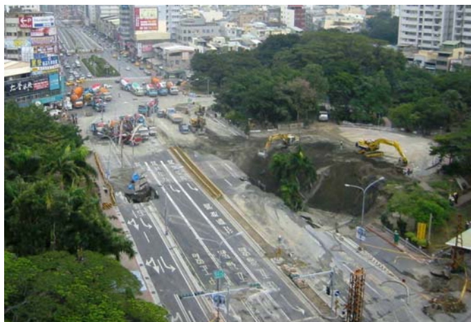
Figura 14 – Colapso de obra subterránea en el Metro Kaohsiung, Taiwan, 2005
