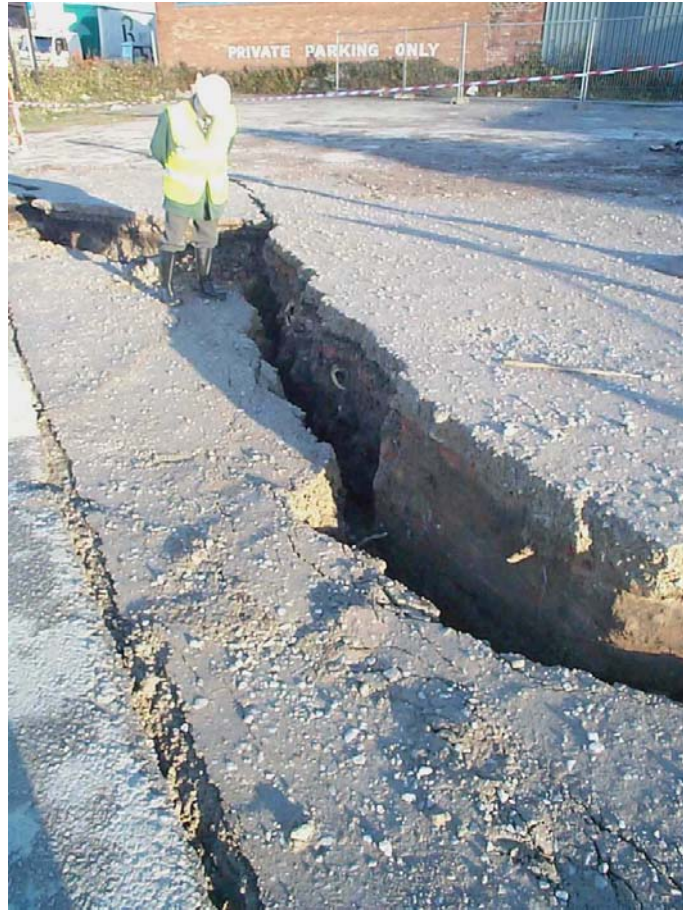
Figura 9 – Colapso del Túnel Hull (interceptor de desagües cloacales), Inglaterra, 1999: asentamientos excesivos y ruptura del macizo por encima del túnel
