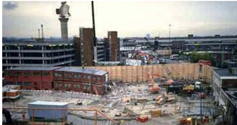
Figura 8 – Vista general del área afectada por el colapso (Heathrow, 1994) después de la demolición de los edificios en ruinas
