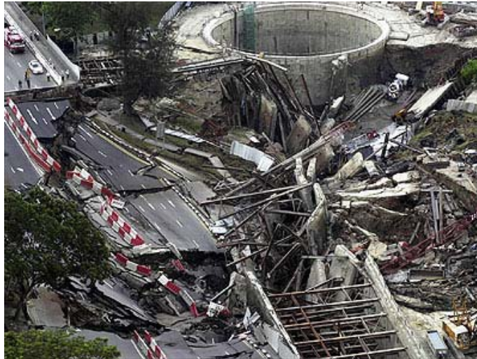
Figura 13 – Colapso en cut and cover de sistema vial en Singapur, 2004
