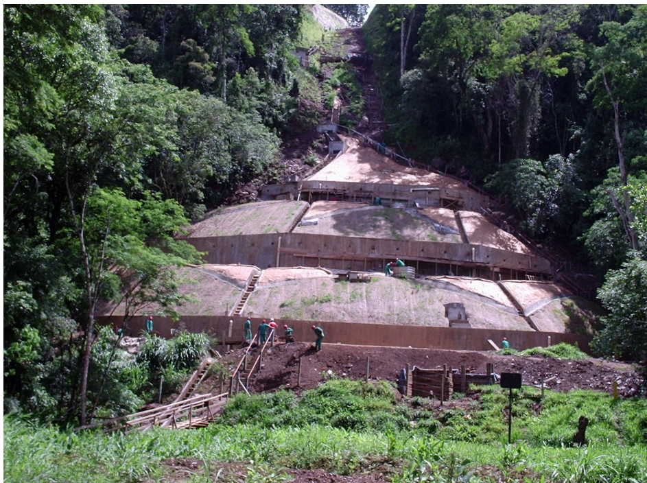
Foto 2 - Cortinas Atirantadas para Estabilização de Encosta em Processo de Movimentação, com riscos à Integridade do Duto
